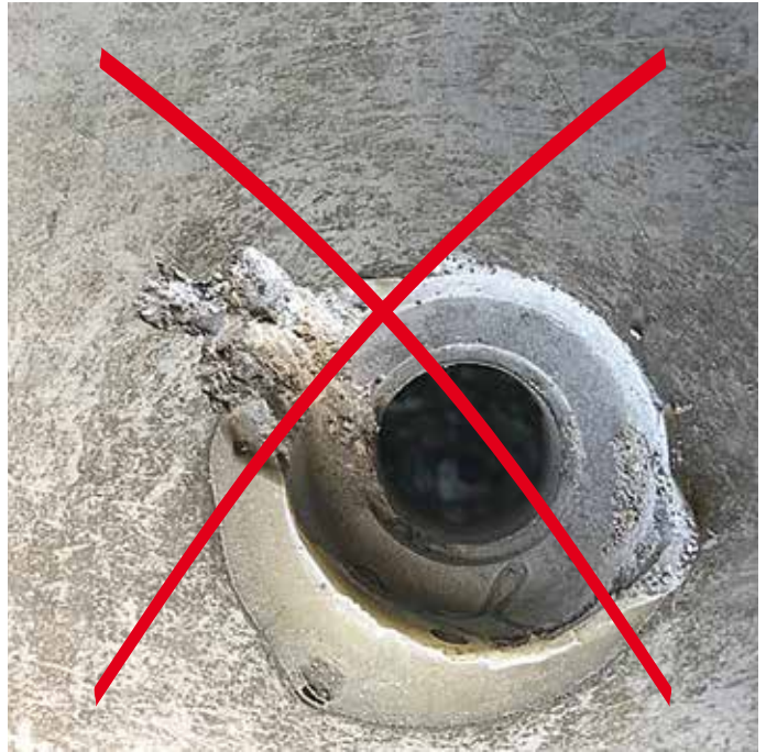
Bild 19: Beschädigung an der Aussparung
