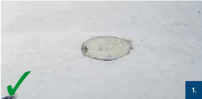
Bild 12: Kunststoffaussparung im Bauteil
