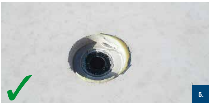
Bild 17: Verbleibende Aussparung im Beton
